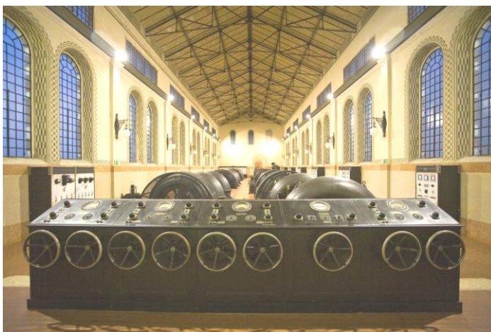
Interno impianto Bondeno-Palata
